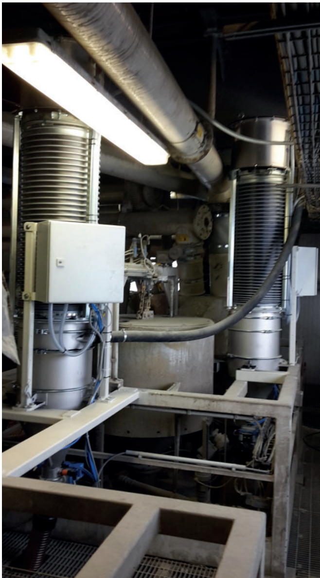
Filterzyklone über den Betonmischern
